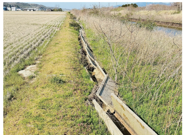
写真-2 排水路の転倒
