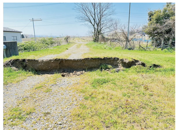
写真-3 農道の沈下
