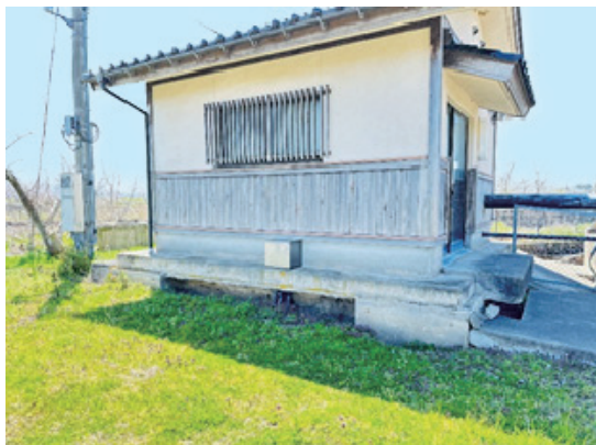
写真-4 揚水機場周辺地盤の沈下
